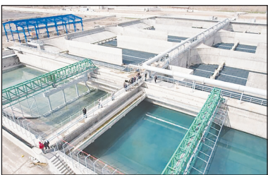
وی خاطرنشان کرد: پروژه تصفیه خانه طبرسی شمالی هم با سرمایه گذاری بخش خصوصی با برآورد ۱،۵۰۰ میلیارد تومان در حال اجرا می‌باشد که پس از پایان ۷۰ هزار مترمکعب بر توان تصفیه خانه‌های شهر مشهد خواهد افزود تا به امروز یک چهارم از عملیات اجرایی و ساخت خود را پشت سر گذاشته و تا پایان سال ۱۴۰۴ بهره برداری خواهد شد.
